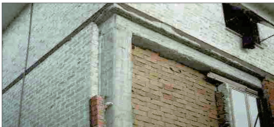
Figura 10. Esempio di dissimmetrie delle tamponature (Manuale AeDES).
